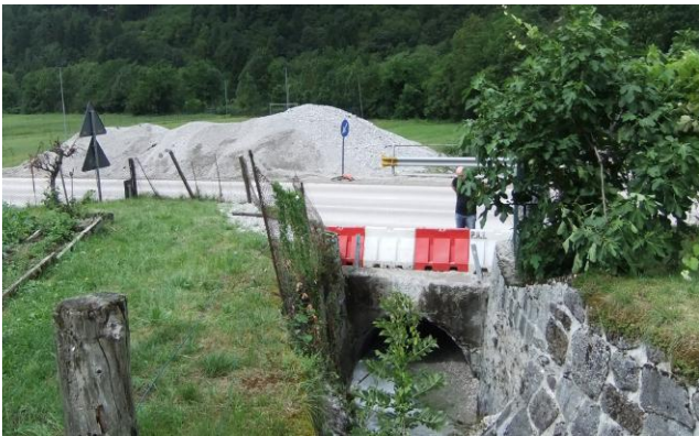
Rio Val del Lupo: materiale rimosso all'altezza dell'attraversamento viario.
