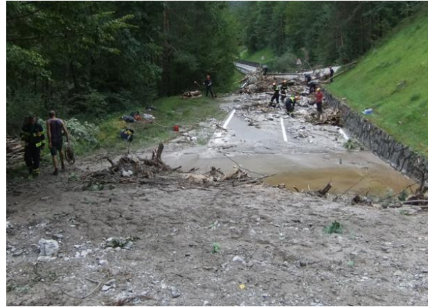
Canali di Storo: personale dei Vigili del Fuoco all'opera per sgomberare la strada dai detriti.
